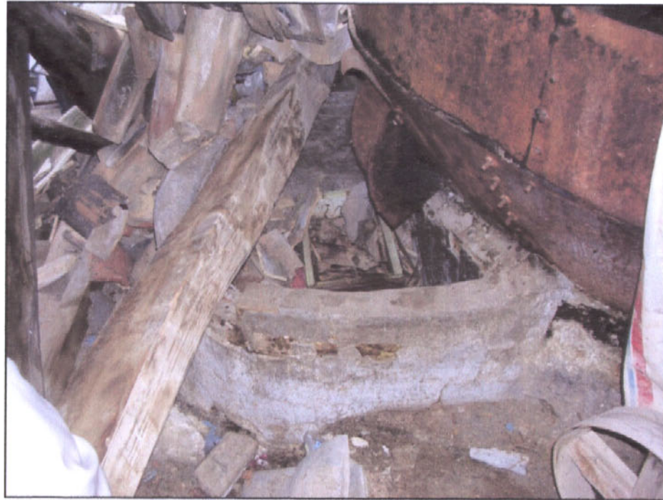
Εικόνα 1.16: Χτιστό δοχείο απορροής στην ποδιά του αλωνιού, από το ελαιοτριβείο του Λέκου στην Πάνορμο. Πηγή: Αρχείο Π. Αραβαντινού.
