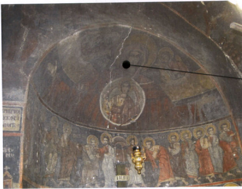
Φωτογραφία 1 : Ρηγματώσεις κατακόρυφες στην κόγχη του Ιερού Βήματος
