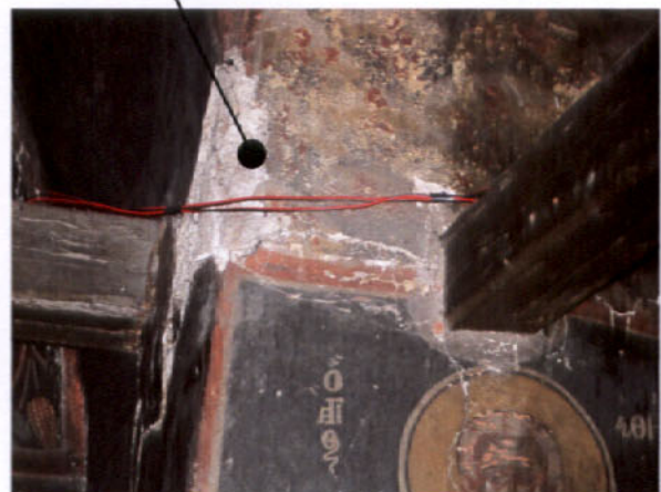
Φωτογραφία 16 : αποκόλληση στη νότια πλευρά
