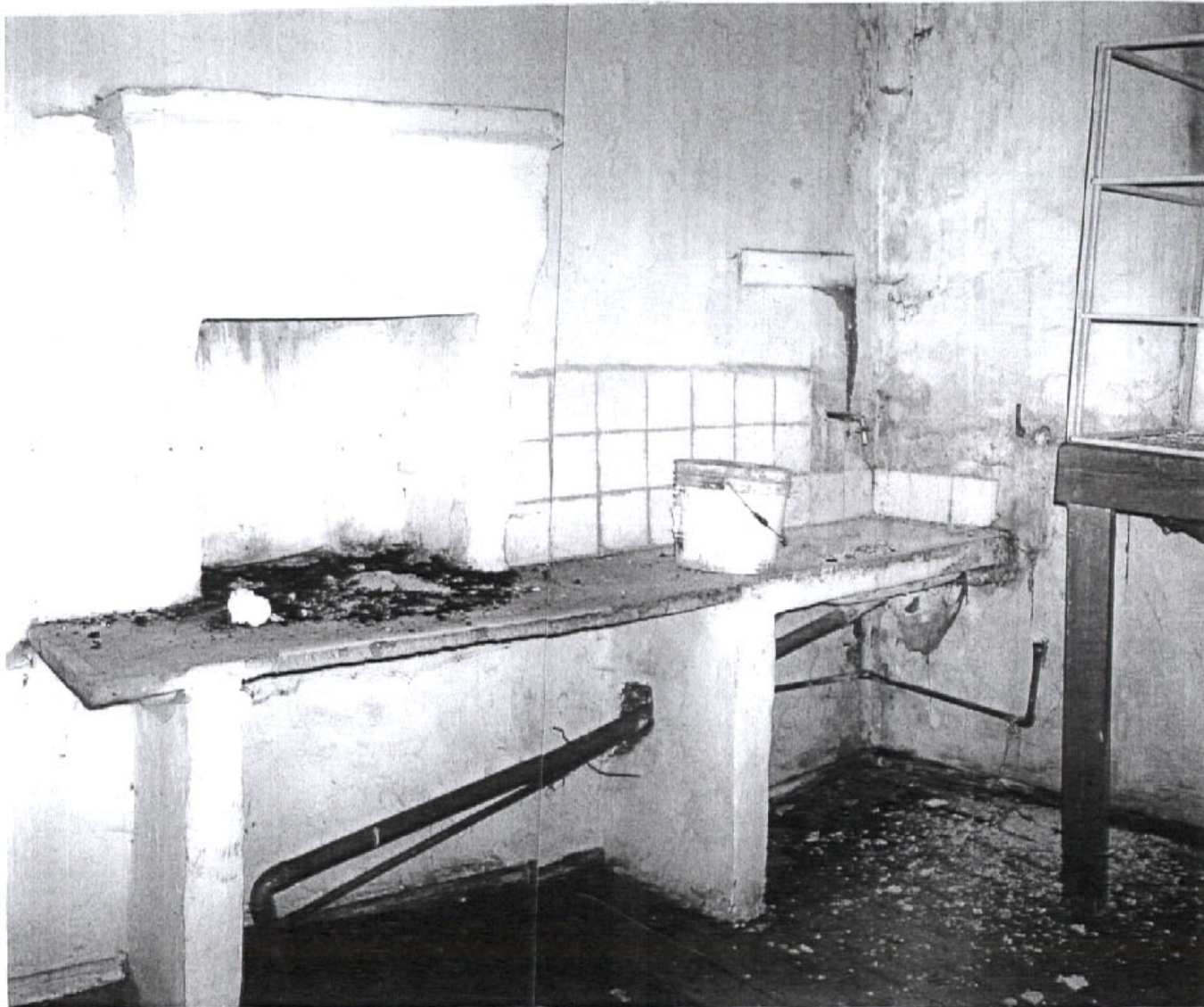
Ένα τυπικό μαγειρείο (κουζίνα) μεταπολεμικών οικημάτων με νεότερη επένδυση από πλακάκια και πρόσφατα «ανακαινισμένες» υδραυλικές εγκαταστάσεις
