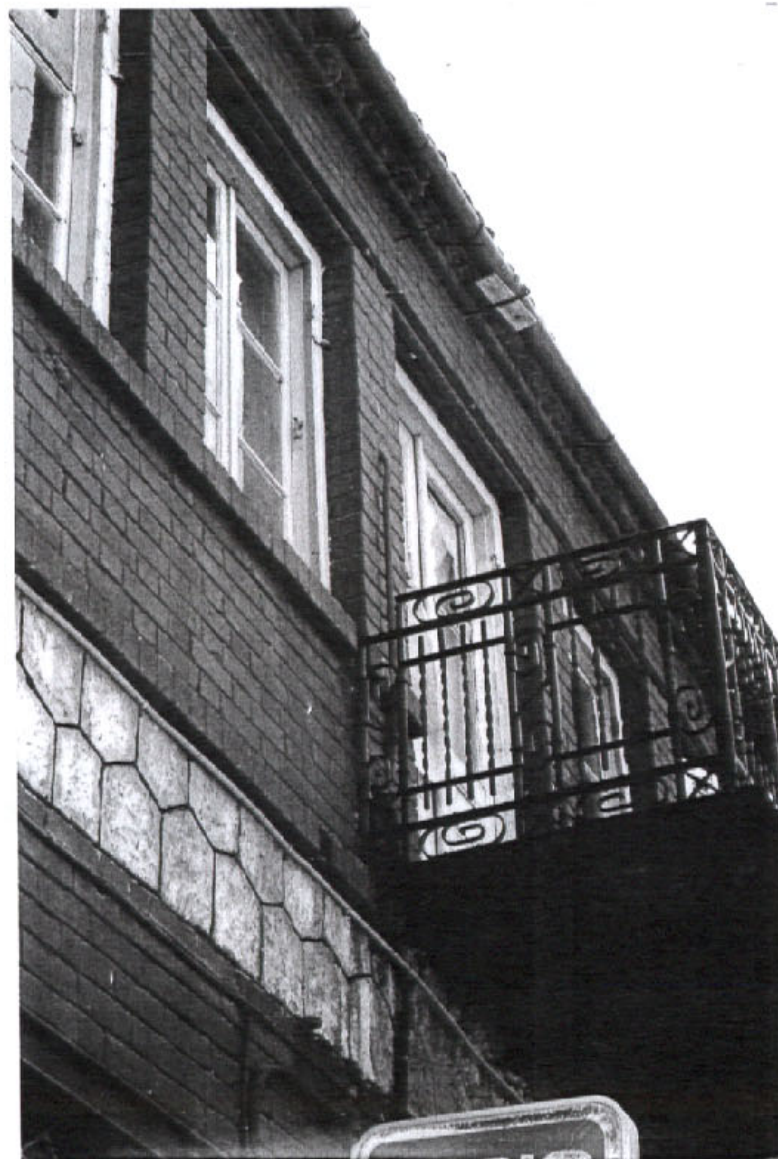
Τα υλικά στην όψη ( κυρλωτή λιθοδομή , κεραμικό τούβλο , μεταλλικές τροχιές , βαρύ παραδοσιακό κιγκλίδωμα , γαλλικό κεραμίδι κ.ό.κ. ) παραπέμπουν σίγουρα σε «σιδηροδρομική» αρχιτεκτονική των αρχών του αιώνα
