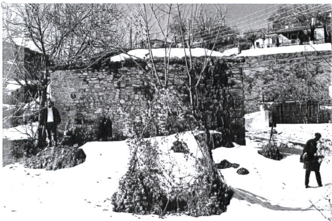
Βορειοδυτική όψη του «Χαμάμ» , όπου τα φερτά χώματα έχουν μπαζώσει τον τοίχο μέχρι το ύψος της ποδιάς του μοναδικού του παράθυρου
