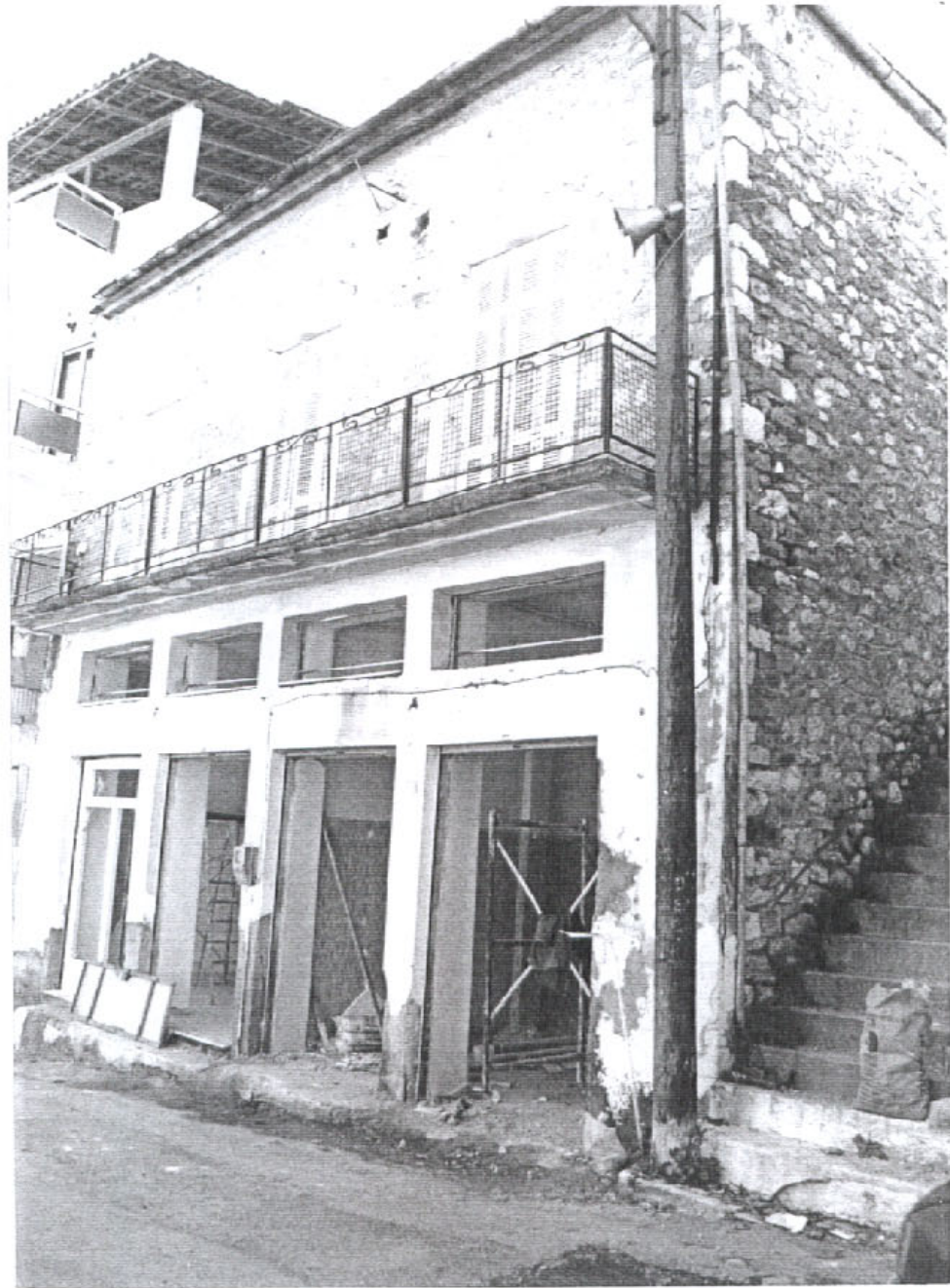
Οι κατά καιρούς οικοδομικές παρεμβάσεις για την «συντήρηση» των οικημάτων κάλυψαν επιφάνειες περίτεχνης πέτρας , όπως μαρτυρούν οι γωνιόλιθοι που παραμένουν με απλοϊκό ασβεστομαρμαροσοβά
