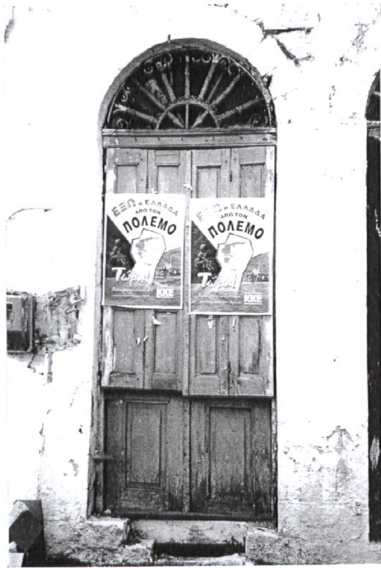
Απλή ξυλόπορτα διπλής λειτουργίας μόνωσης και συσκότισης συγχρόνως, αφού στο δίφυλλο τζαμιλίκι είναι κρεμασμένα και τετράφυλλα σκούρα.
