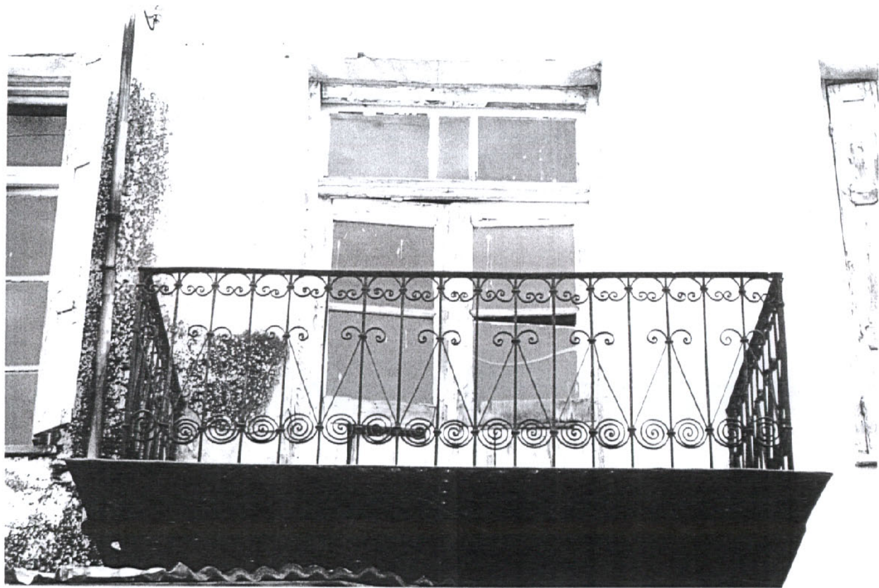
Το μεταλλικό , περιορισμένου μήκους μπαλκόνι , με το περίτεχνο μεταλλικό κιγκλίδωμα , συνήθως αστέγαστο , είναι βασικό μορφολογικό στοιχείο που ποικίλει την όψη των ορόφων των αστικών οικημάτων
