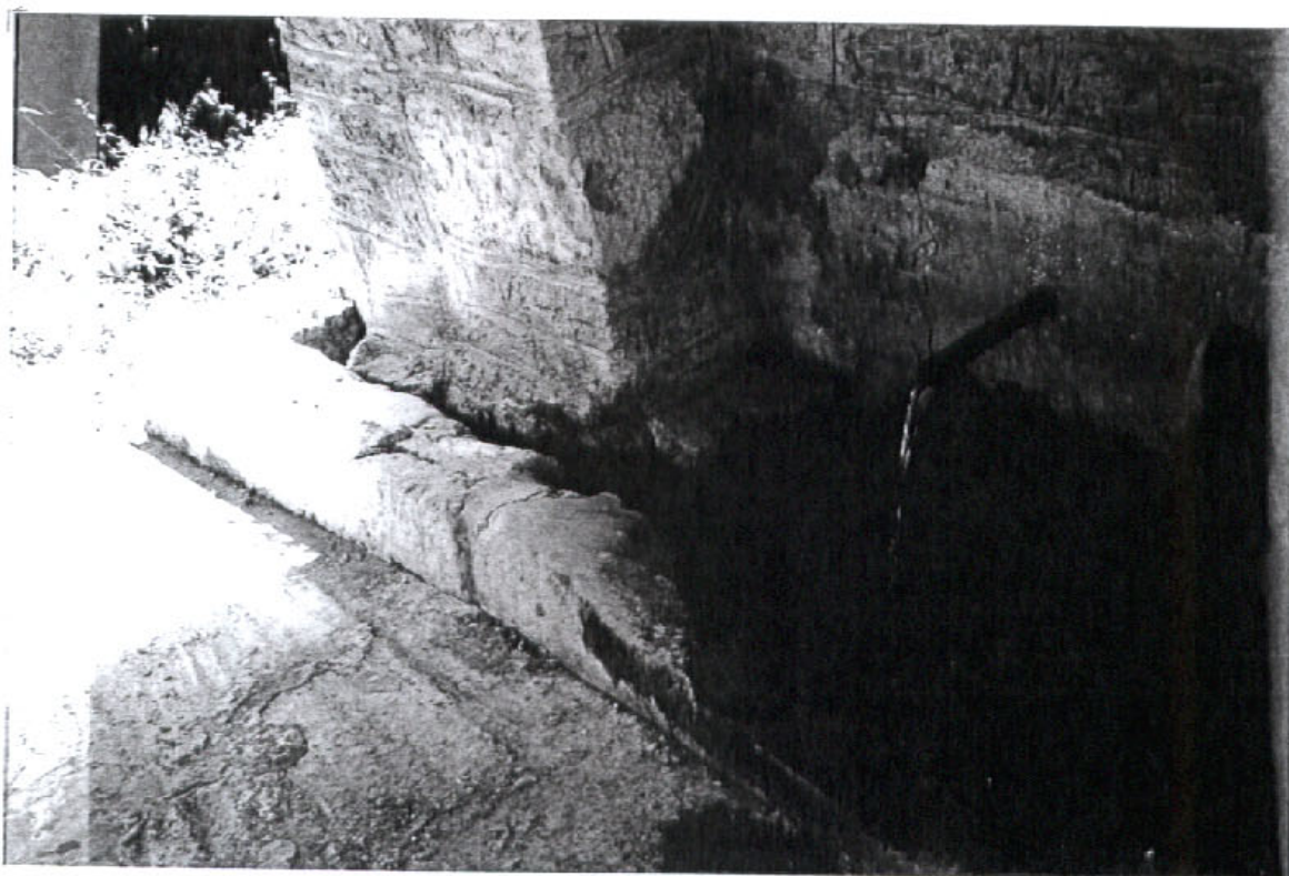
Με κατεργασμένα λιθαγκώναρα , αρμολογημένα με τσιμεντοκονία και ραβδόμορφο αρμό έχει ανακατασκευασθεί σε ένα μεγάλο μέρος η «Αραβική Κρήνη» , με πιθανό πρόβλημα την τελική στάθμη του λιθόστρωτου που σήμερα πλέον δεν διευκολύνει πολύ τον περαστικό να ξεδιψάσει
