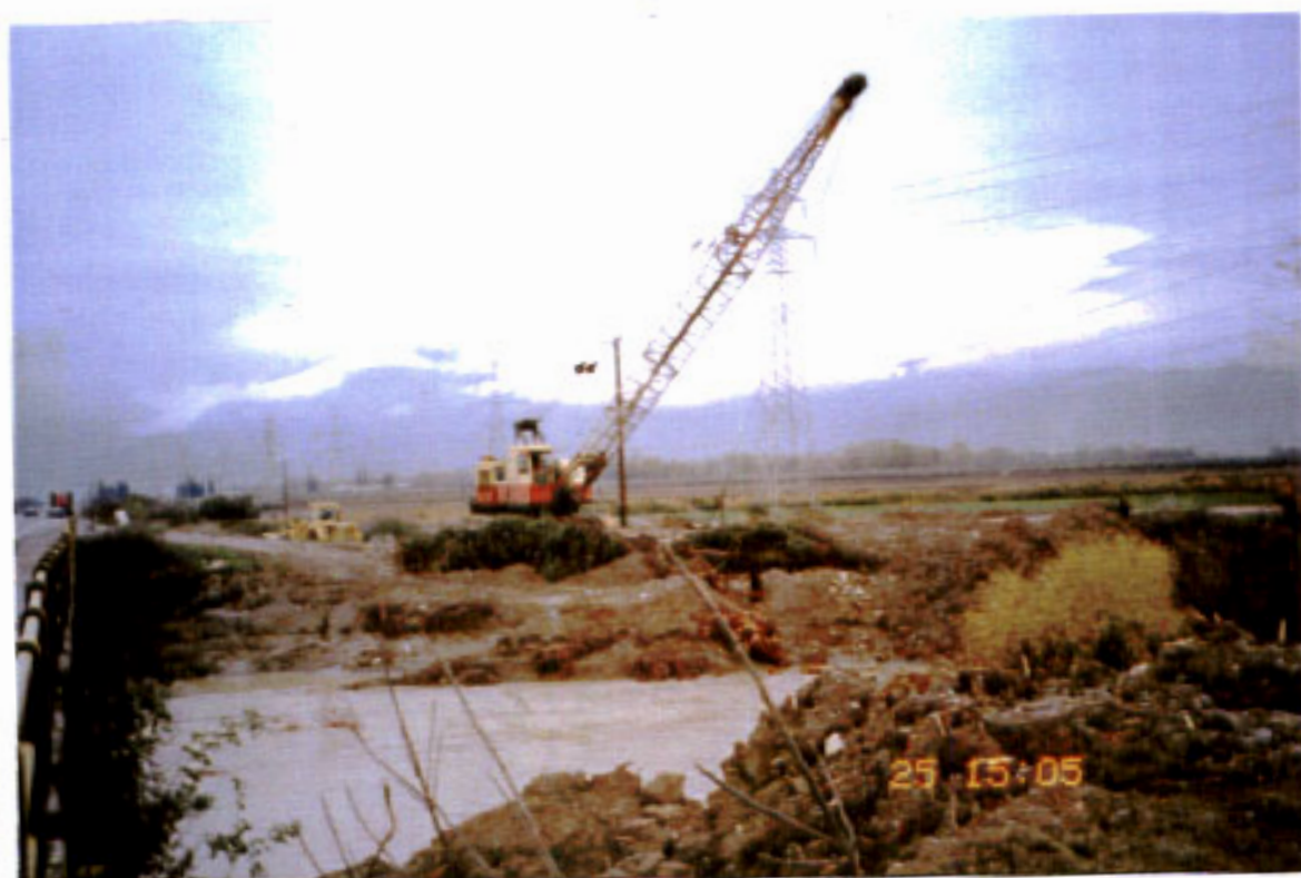
ΦΩΤ. 57-58 : Εκτροπή Σπερχείου κατά την διάρκεια της πλημμυρας και του καθαρισμου .
