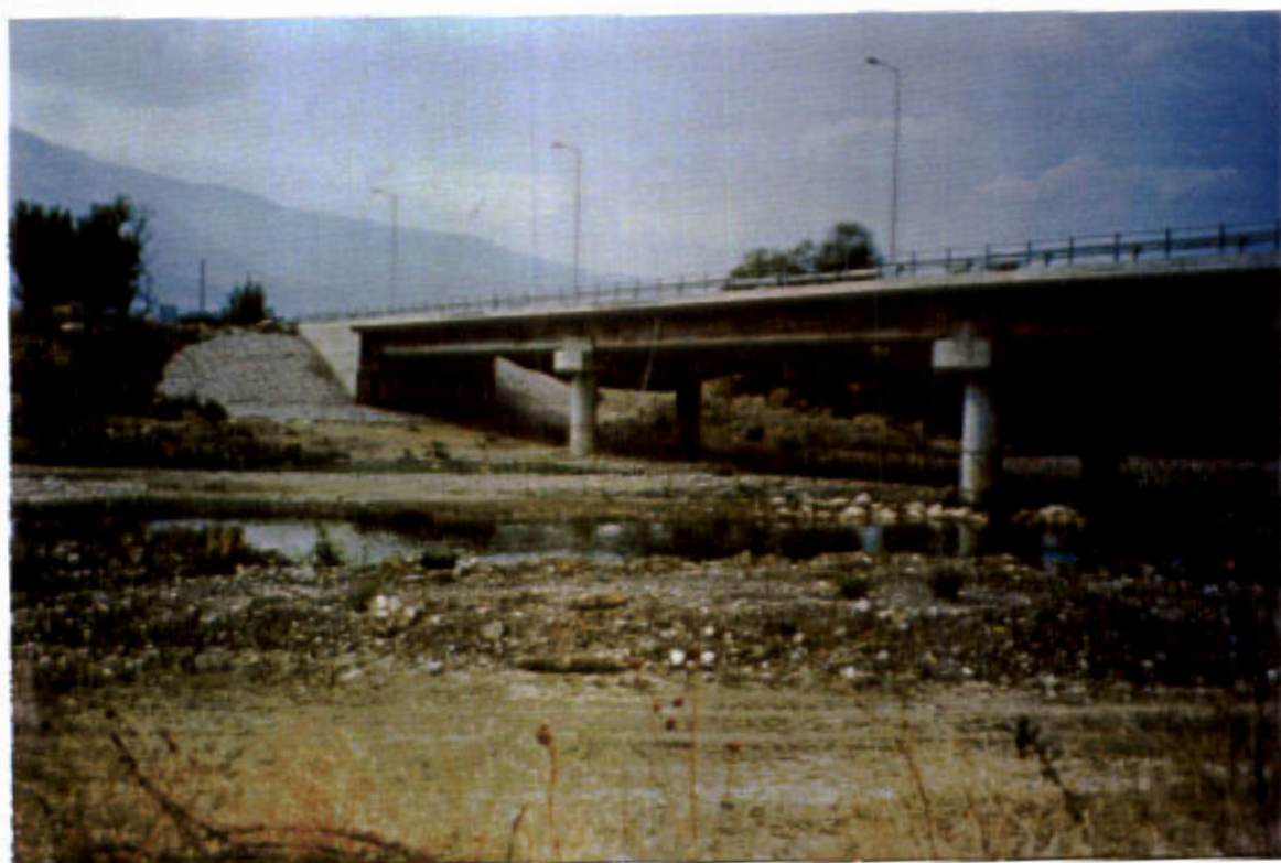
ΦΩΤ. 85-86 : Ανακατασκευή γέφυρας Λιανοκλαδίου — Υπάτης Η διευσθέτηση της κοίτης του Σπερχειού ανάντι και κατόντι του τεχνικού είναι ανύπαρκτη
