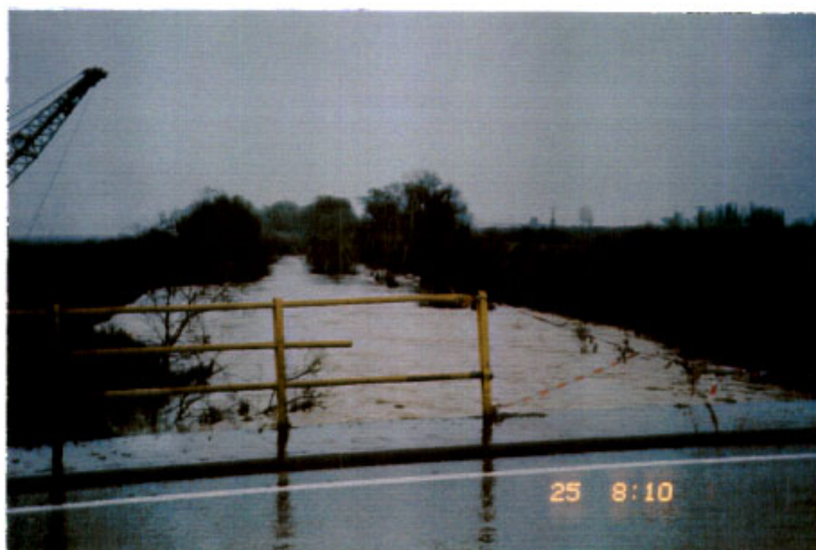
Φ Ω Τ. 23 - 24 : Αποτελέσματα πλημμυρών στη γέφυρα Κομποτάδων και Αλαμάνας
