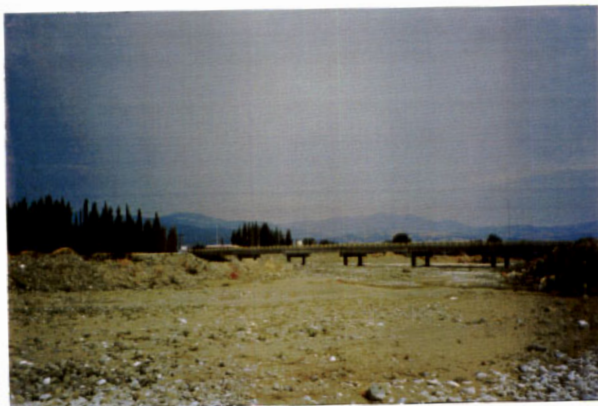
ΦΩΤ. 89-90 : Ανακατασκευή γέφυρας Μακραχώμης - Σπερχειάδας Η διευσθέτηση της κοίτης του Σπερχειού ανάντι και κατόντι του τεχνικού είναι ανύπαρκτη
