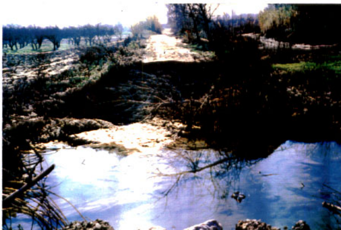
ΦΩΤ. 17 - 18 : Καταστροφές πλημμυρων σε αναχώματα του οδ.ικου δικτύου
