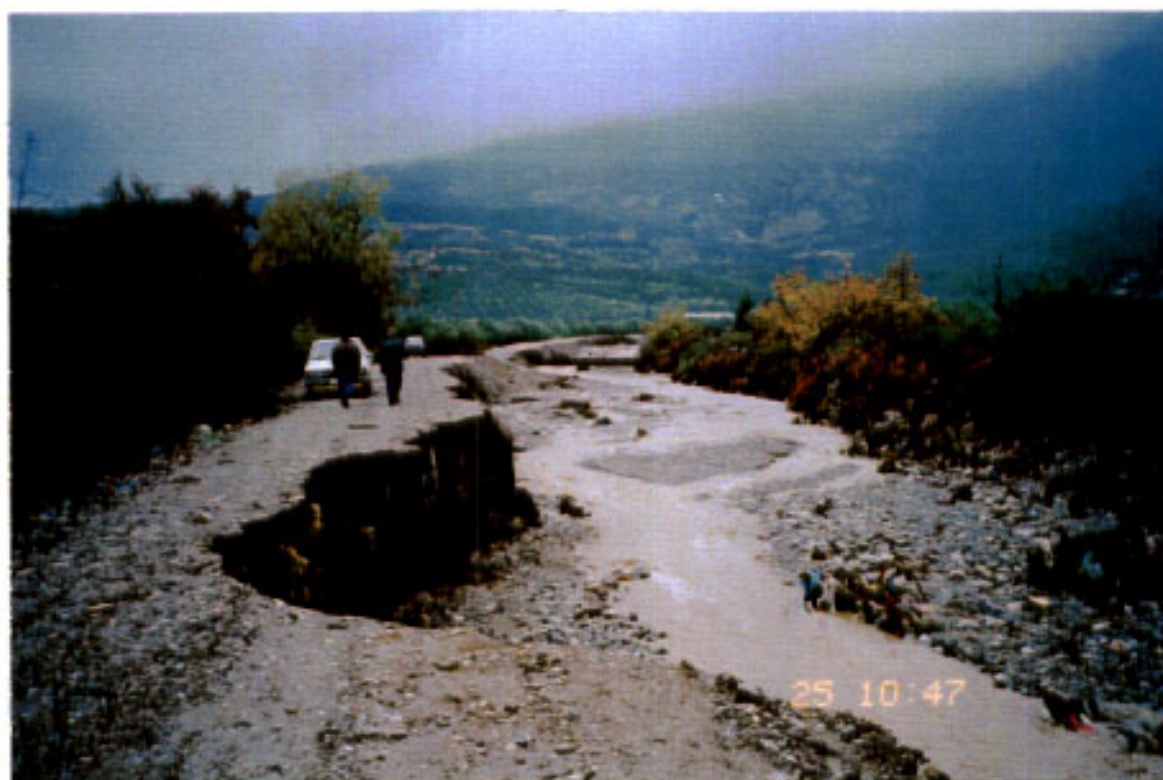
ΦΩΤ. 21-22 : Συσσώρευση φερτών υλών και καταστροφή αναχωμάτων
