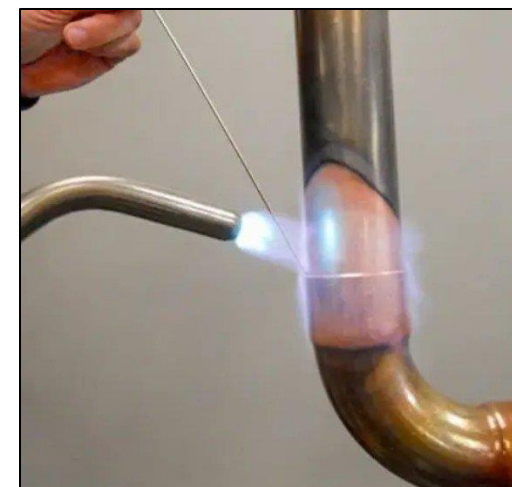
Σύνδεση με σκληρή κόλληση
