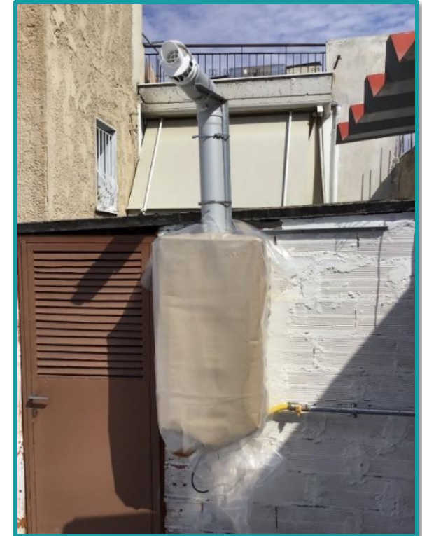
Τοποθέτηση λέβητα σε άγνωστης δομικής ποιότητας κτίσμα
