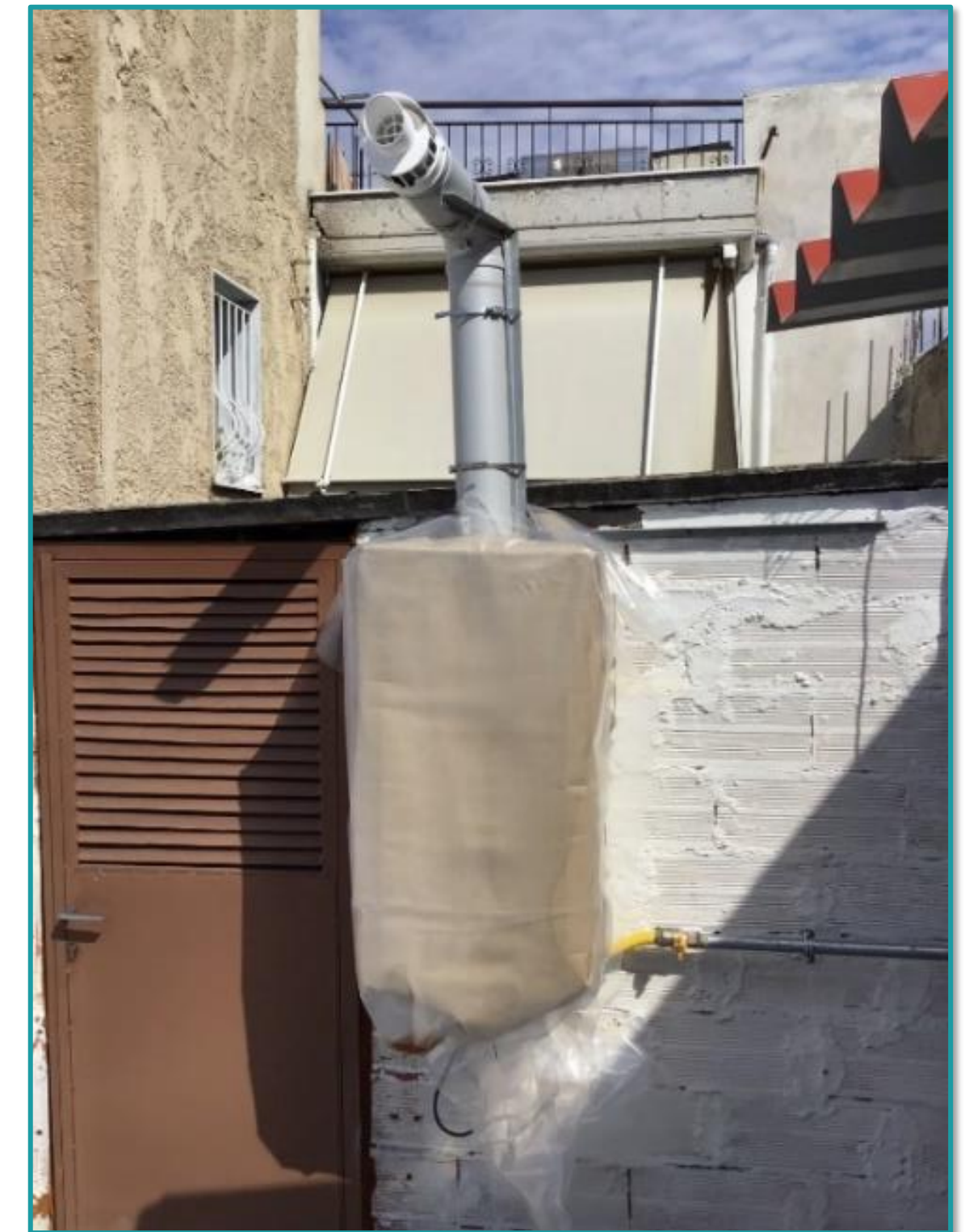
Τοποθέτηση λέβητα σε άγνωστης δομικής ποιότητας κτίσμα
