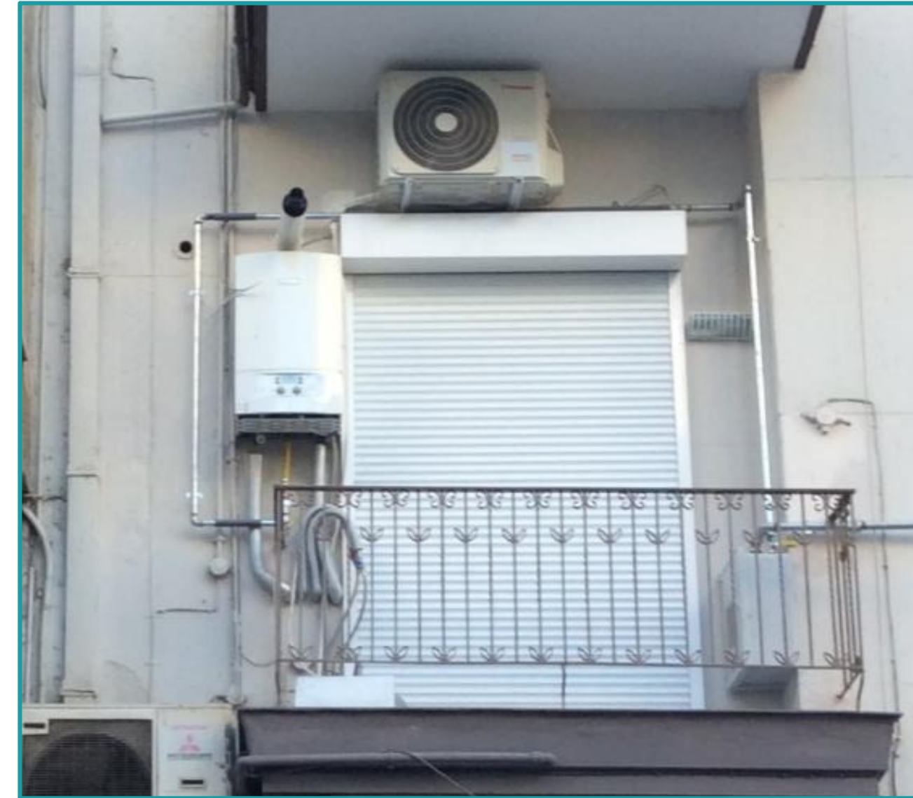
Τοποθέτηση λεβήτων σε μπαλκόνια
